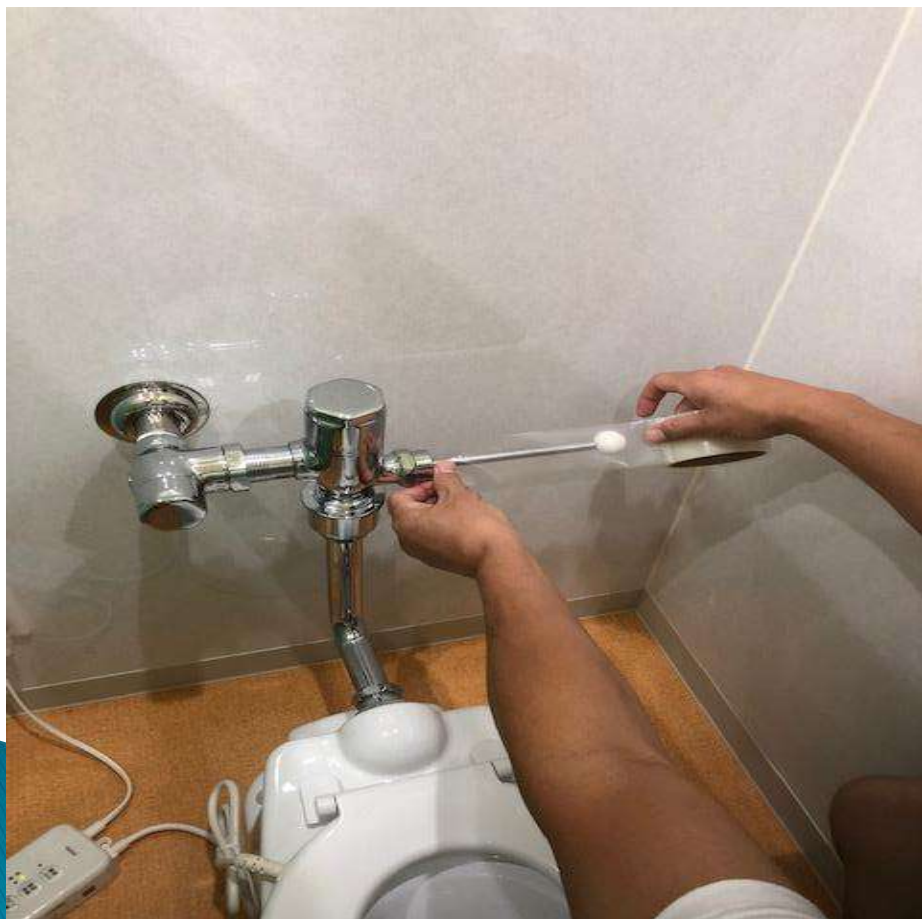
トイレの洗浄レバー
